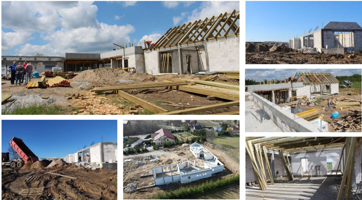
Rysunek 91. Fotorelacja z budowy Świetlicy Wiejskiej w Różnowie (źródło: materiały własne Gminy Dywity).
