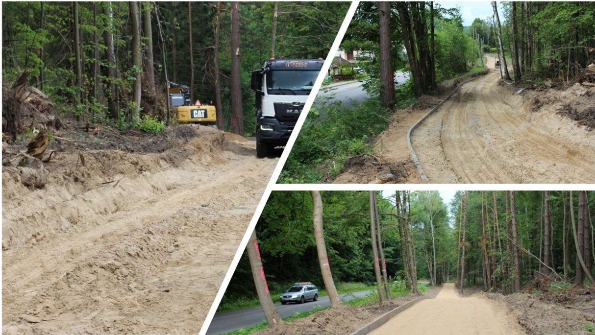
Rysunek 87. Fotorelacja z prac realizowanych w ramach budowy ciągu pieszo-rowerowego Słupy-Wadąg (źródło: materiały własne Gminy Dywity).
