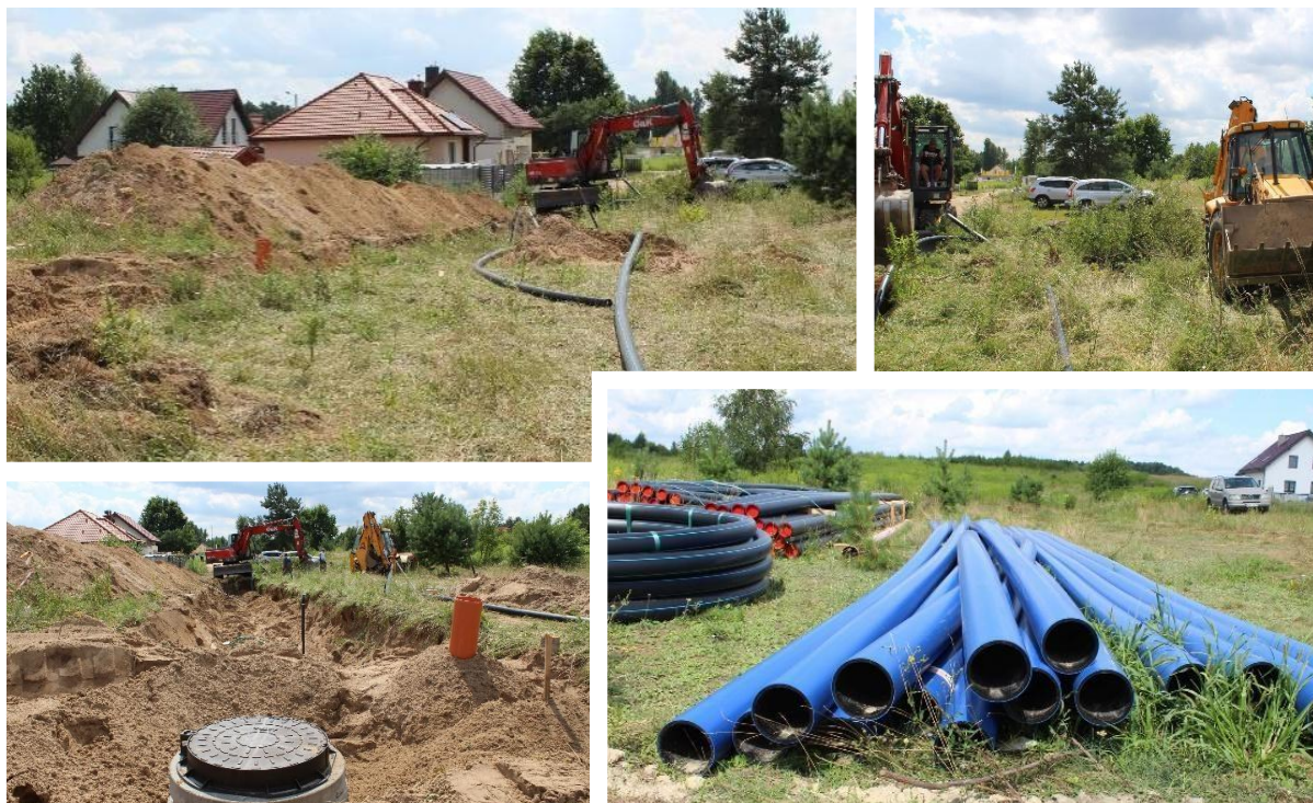
Rysunek 32. Fotorelacja - realizacja inwestycji budowa wodociągu oraz kanalizacji sanitarnej w miejscowości Myki.
