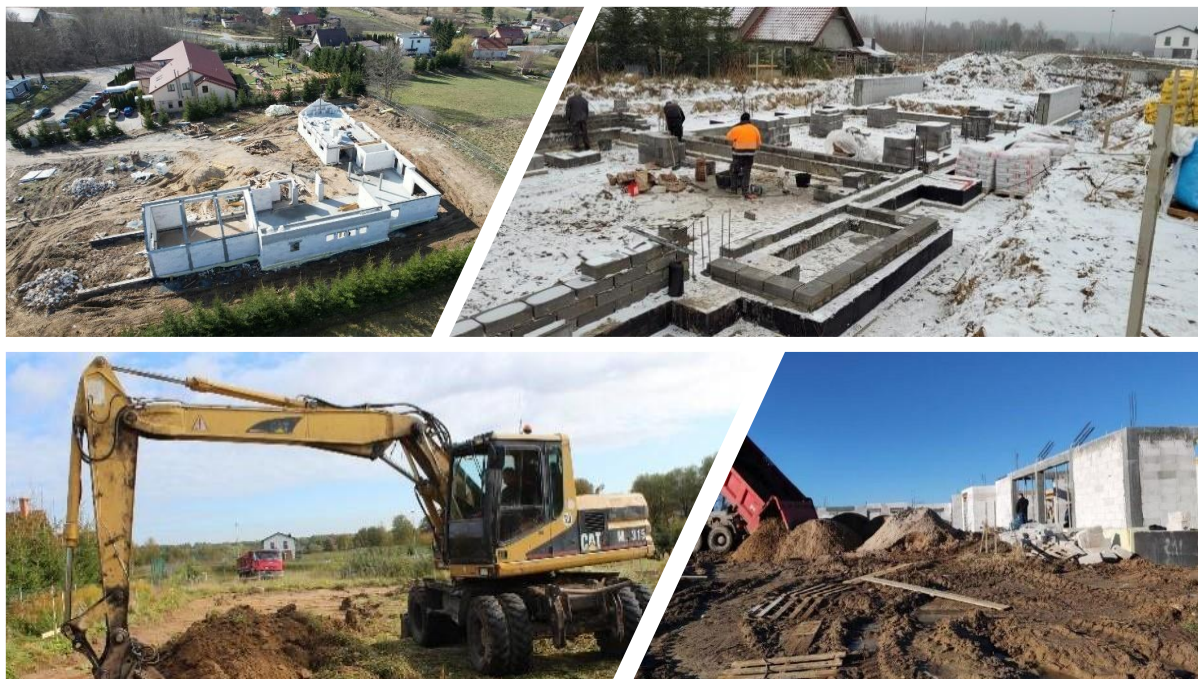
Rysunek 35. Fotorelacja - realizacja inwestycji „budowa świetlicy wiejskiej wraz z zapleczem sportowym w Różnowie”.
