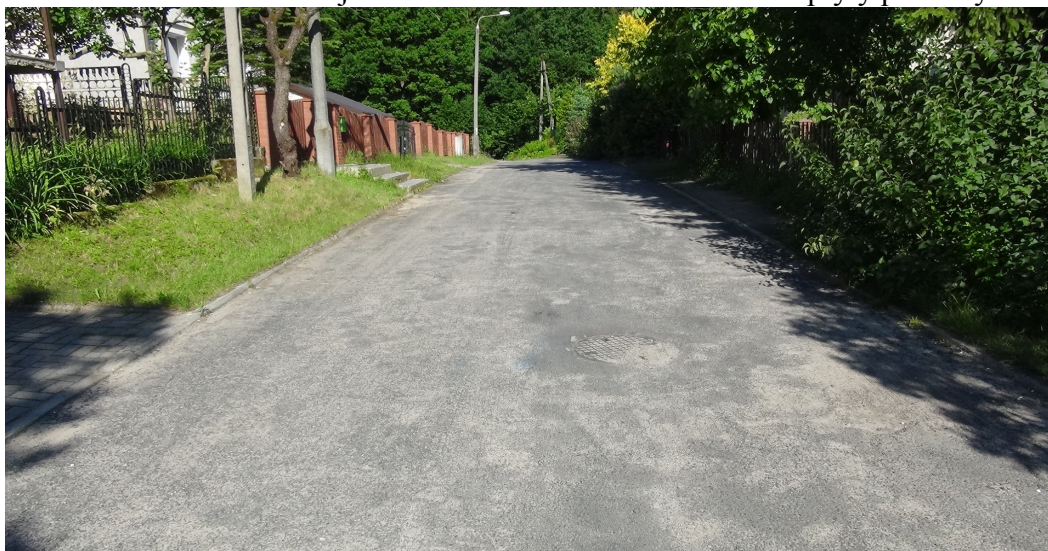
Fot. Nr 3 nawierzchnia dojazdu działka nr 234(beton przykryty destruktem bitumicznym)
