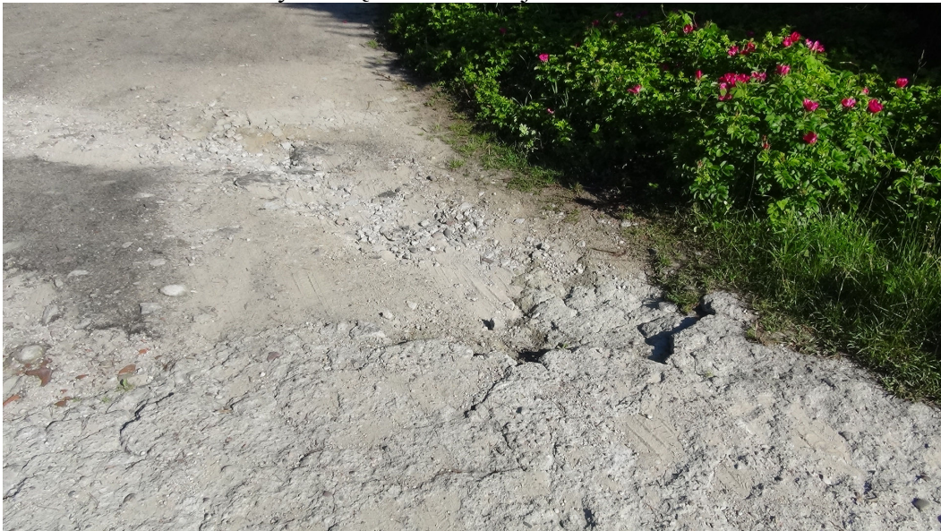
Fot. Nr 5 stan techniczny nawierzchni wymagającej uzupełnienia podbudowy bet.
