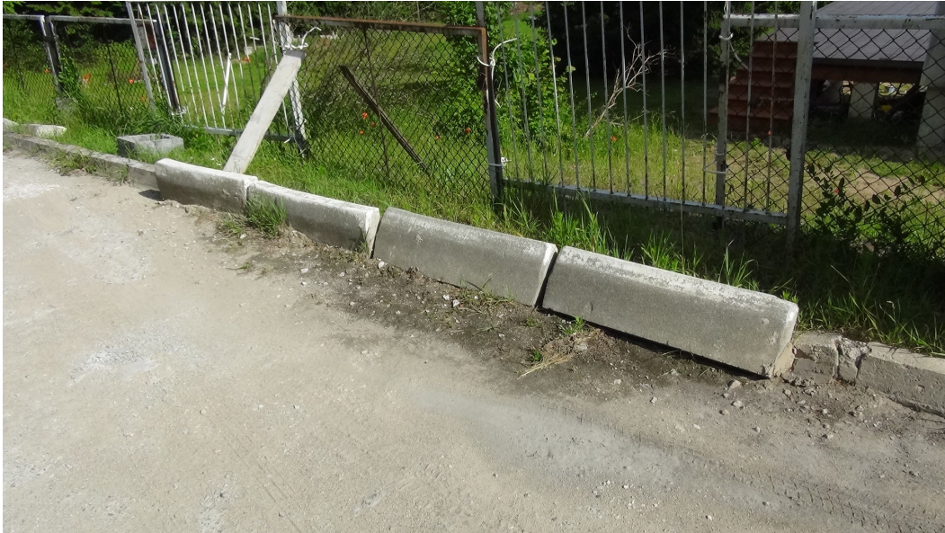
Fot. Nr 4 stan techniczny krawężników na dojeździe
