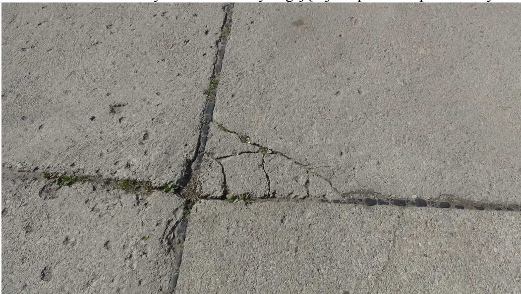
Fot. Nr 5 stan techniczny nawierzchni uszkodzenia wynikające z przemieszczeń.
