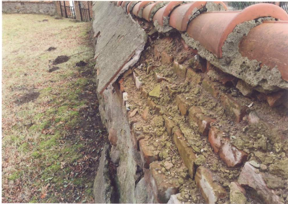
Fot 25. Stan zachowania materiału ceramicznego korony muru
