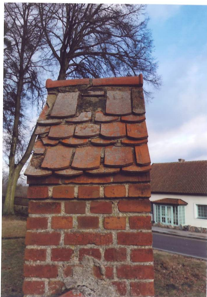
Fot 52 Stan zachowania pokrycia słupów z dachówki ceramicznej
