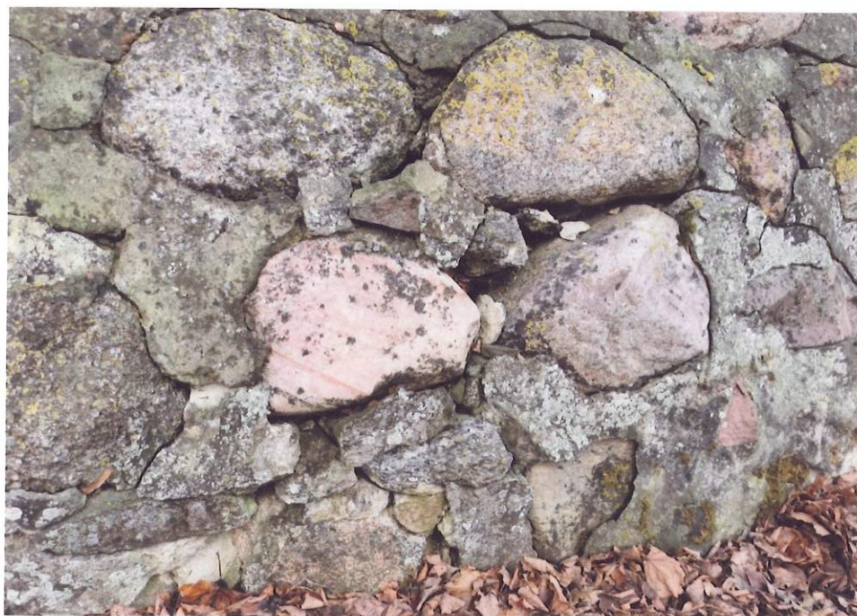
Fot 34 Ubytki zaprawy spajającej materiał kamienny, wtórne cementowe reparacje
