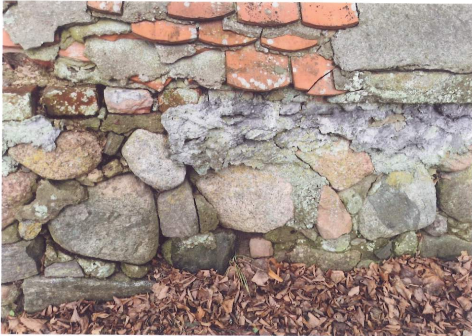
Fot 31 Ubytki zaprawy spajającej materiał kamienny, wtórne cementowe reparacje
