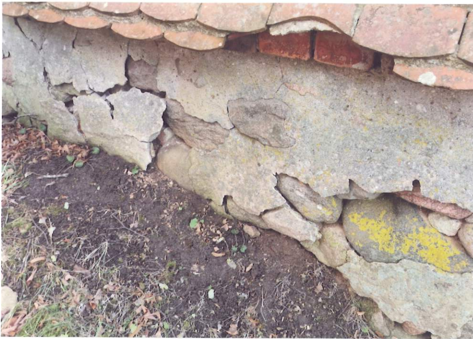
Fot 43 Wtórne odparzone szlichty cementowe
