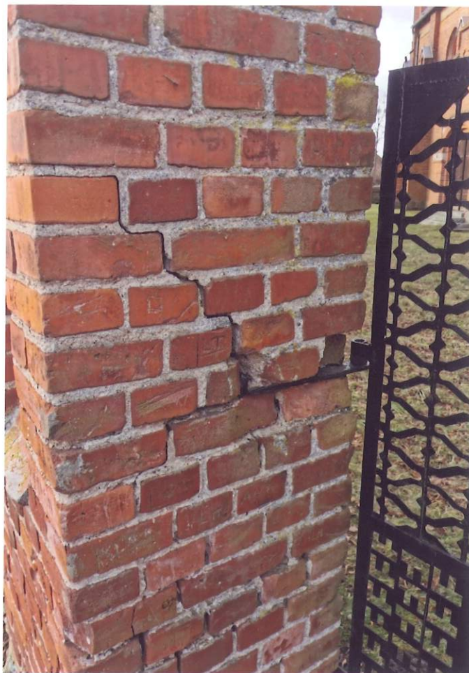
Fot 53 Uszkodzenia elementów ceglanych słupów
