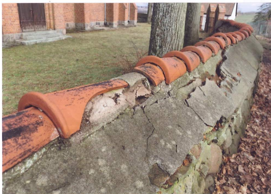
Fot 16 Stan zachowania nakrywy muru
