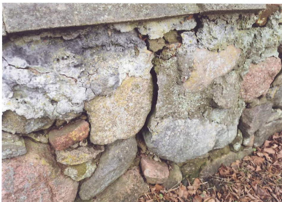
Fot 30 Pęknięcia konstrukcji muru, ubytki zaprawy spajającej
