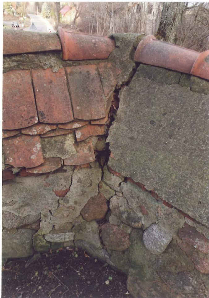
Fot 46 Pęknięcia naroża od strony północno-wschodniej
