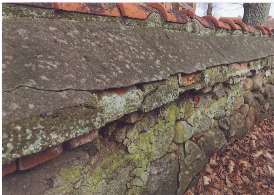
Fot 18 Stan zachowania nakrywy muru
