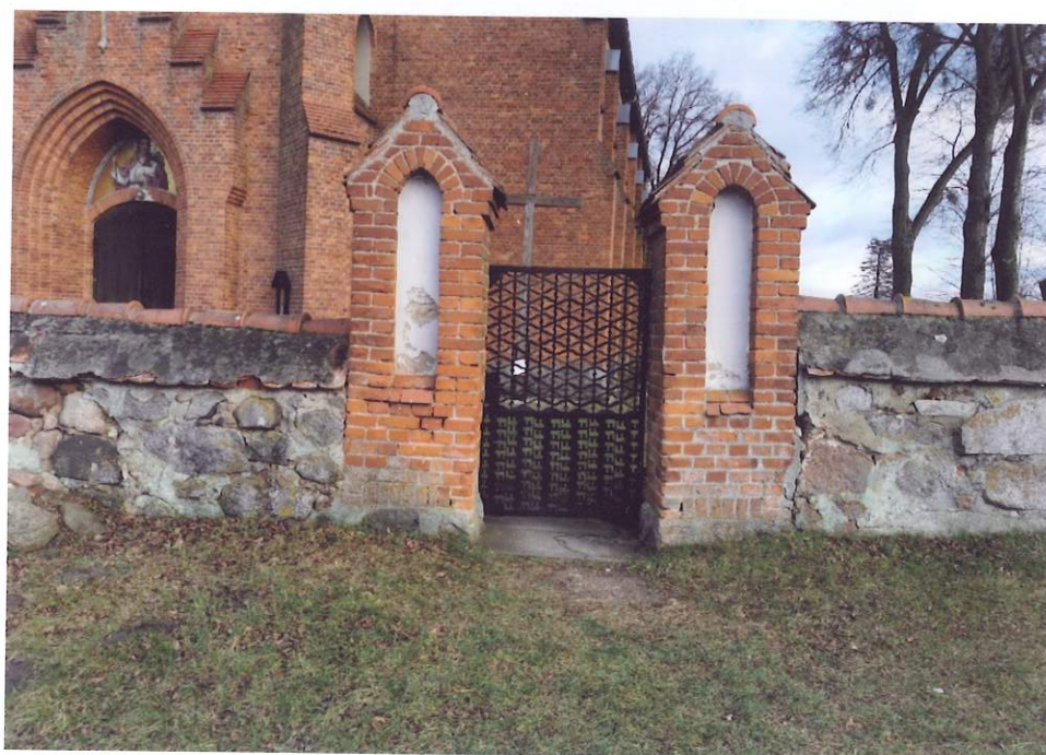
Fot 50 Ceglane słupy wtórna stalowa furta
