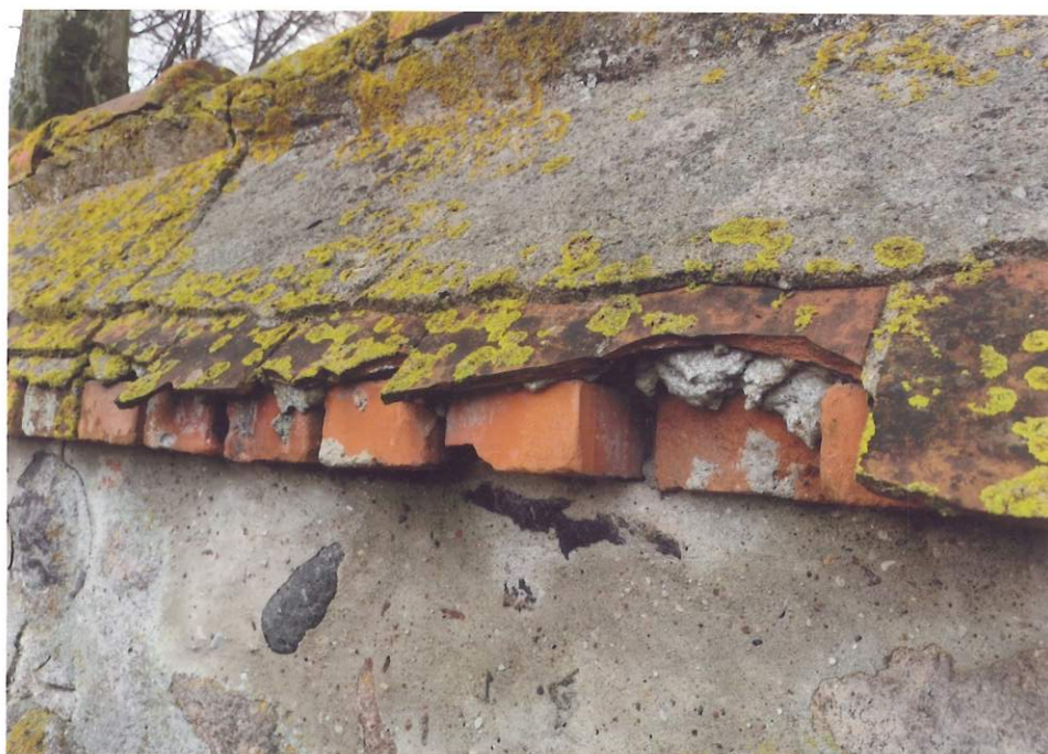
Fot 27 Korozja biologiczna
