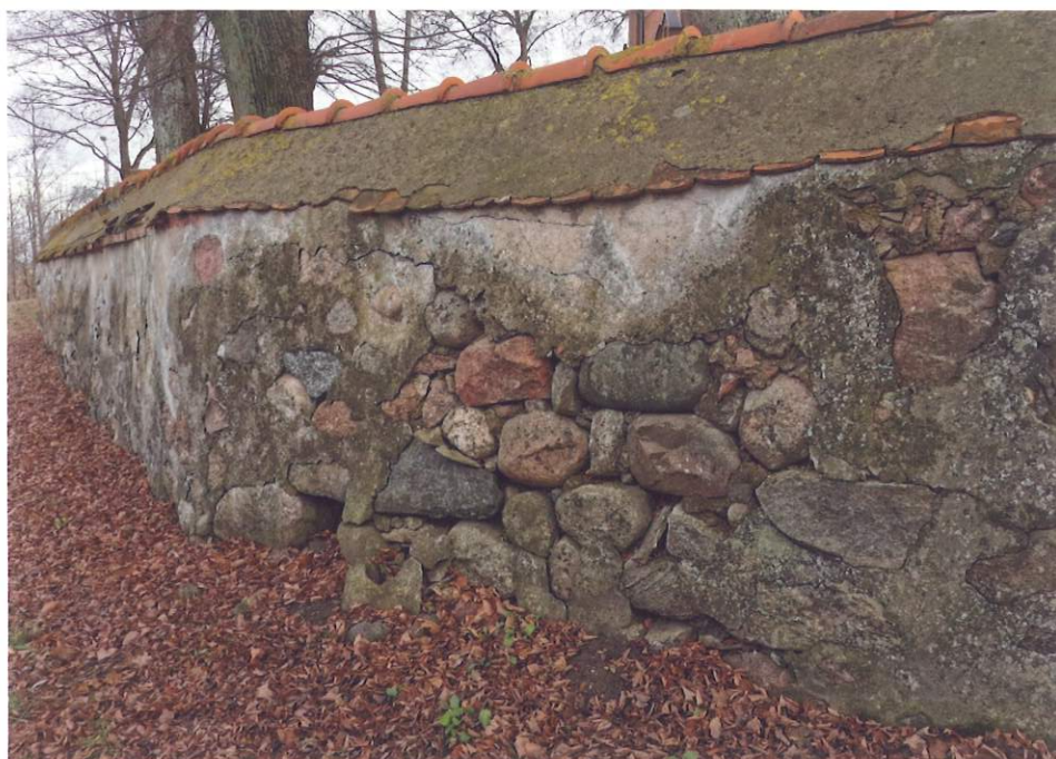
Fot 29 Korozja biologiczna
