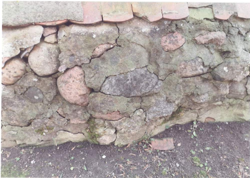
Fot 44 Wtórne spękane wypełnienia cementowe wykonane zbyt silnymi zaprawami
