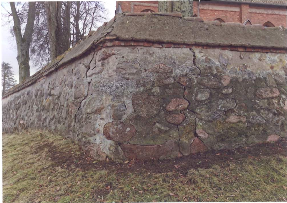
Fot 45 Odspojenie naroża muru od strony północno-wschodniej
