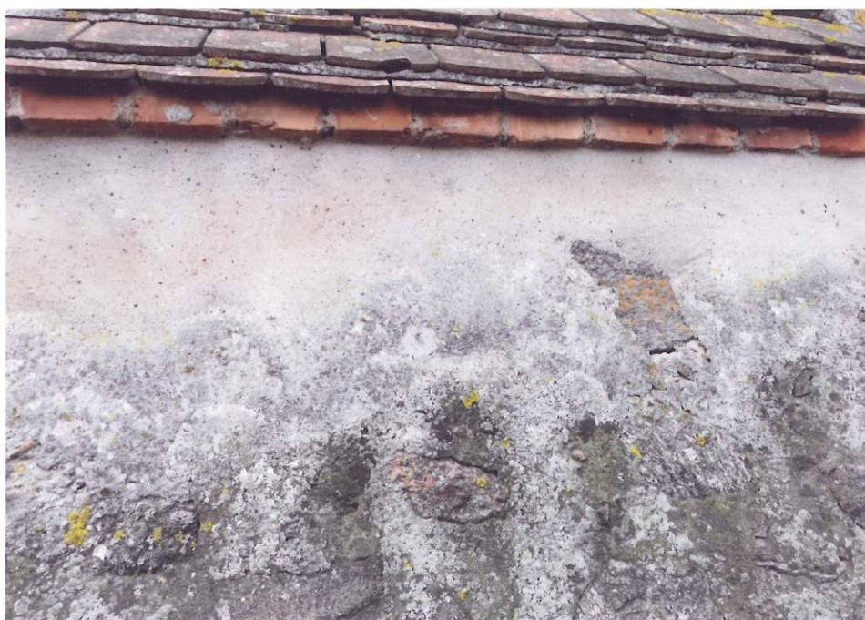
Fot 42 Wtórne szlichty cementowe pokrywające materiał kamienny
