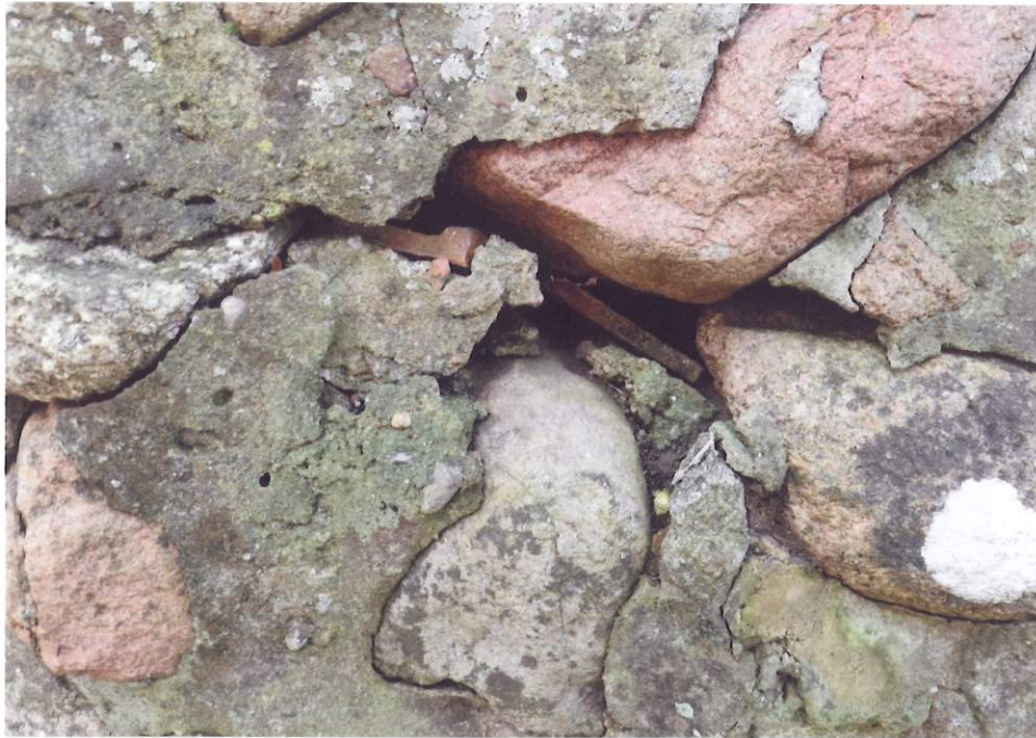
Fot 37. Ubytki zaprawy spajającej materiał kamienny, wtórne cementowe reparacje
