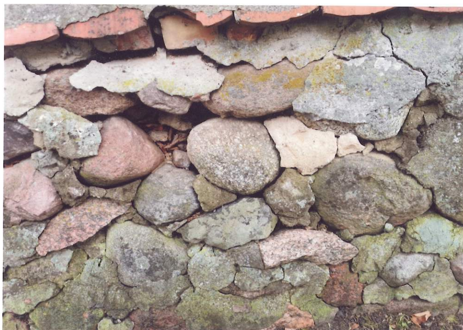
Fot 36 Ubytki zaprawy spajającej materiał kamienny, wtórne cementowe reparacje
