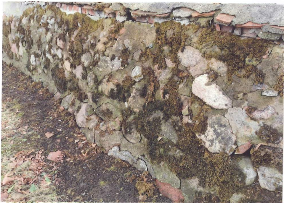
Fot 26. Korozja biologiczna pokrywająca powierzchnię muru
