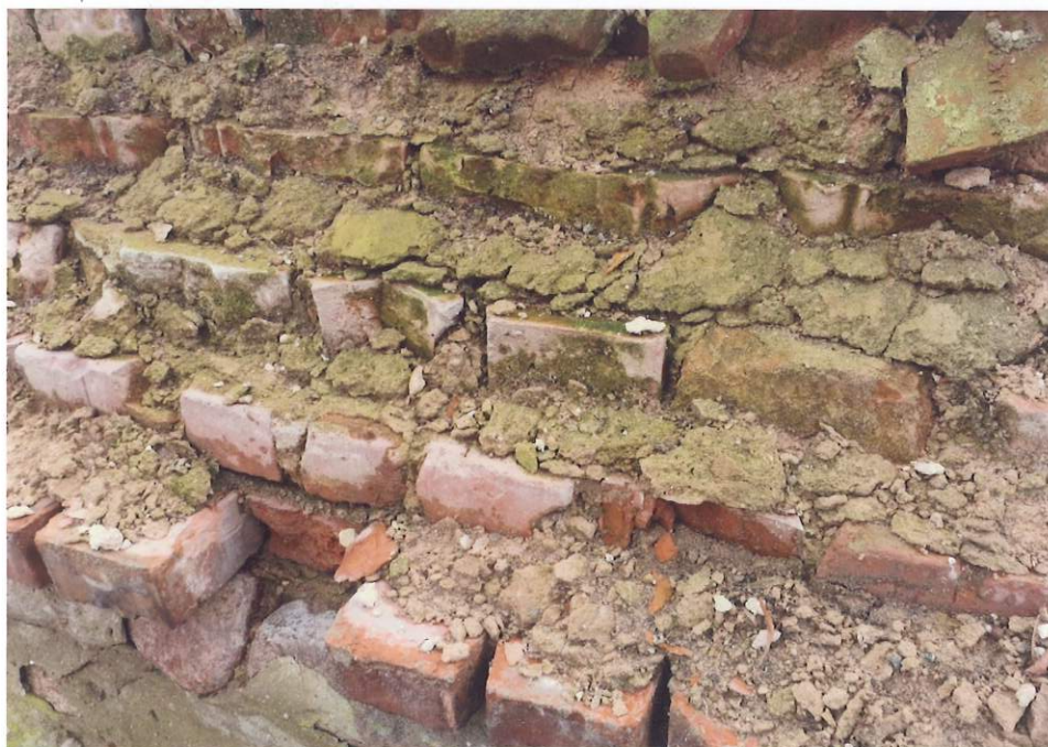
Fot 24. Stan zachowania materiału ceramicznego korony muru
