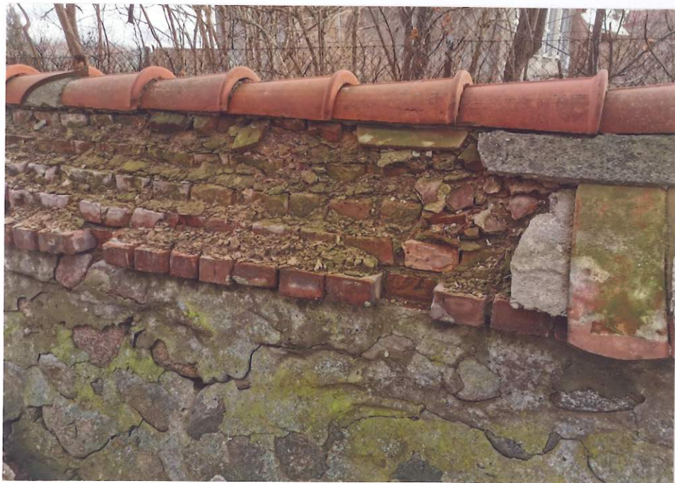
Fot 22. Uszkodzenia korony muru
