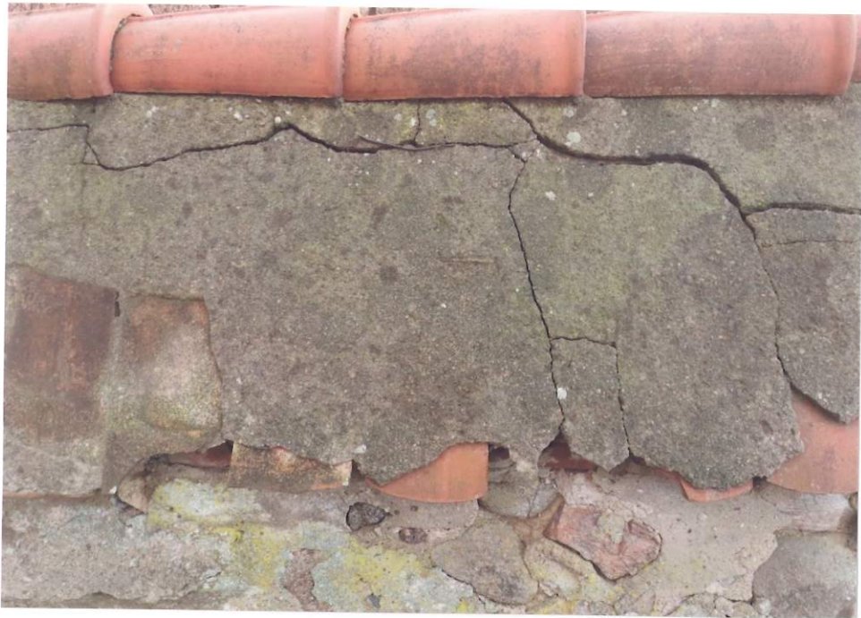
Fot 19 Stan zachowania nakrywy muru
