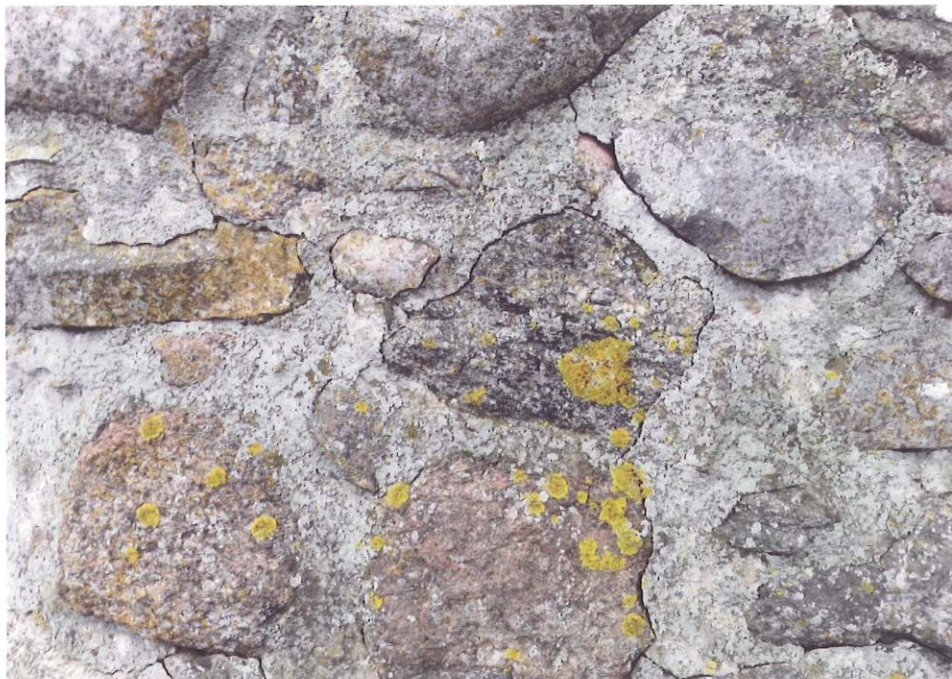
Fot 41. Wtórne uzupełnienia cementowe spoin
