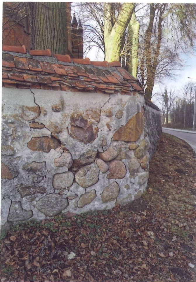
Fot 47 Odspojenie naroża od strony południowo-wschodniej
