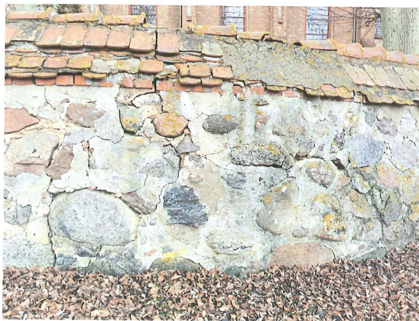
Fot 48 Spękania muru
