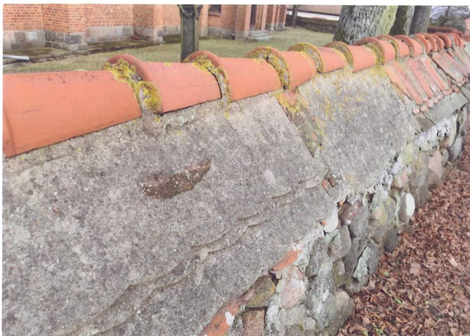
Fot 15 Wtórna szlichta cementowa pokrywająca ceramiczną nakrywę
