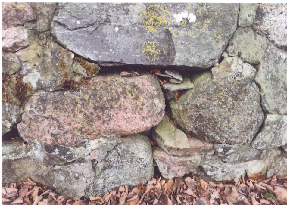
Fot 33 Ubytki zaprawy spajającej materiał kamienny
