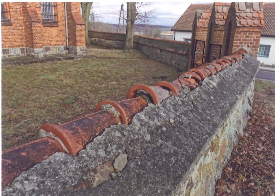
Fot 17 Wtórna szlichta cementowa pokrywająca ceramiczną nakrywę
