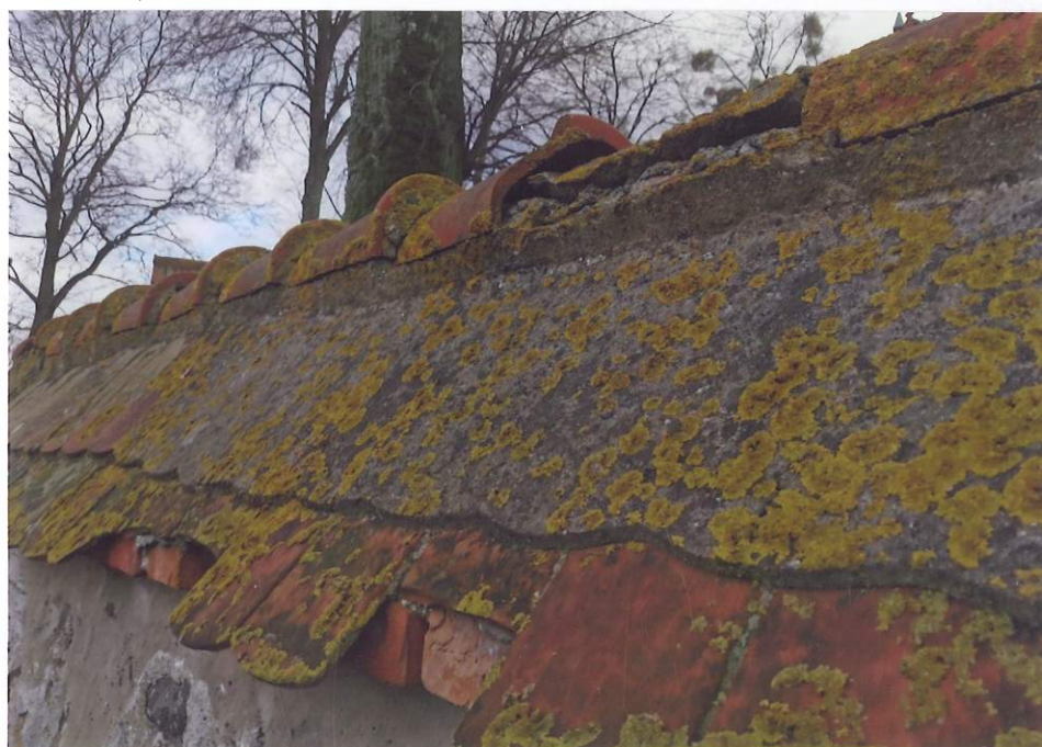
Fot 28 Korozja biologiczna
