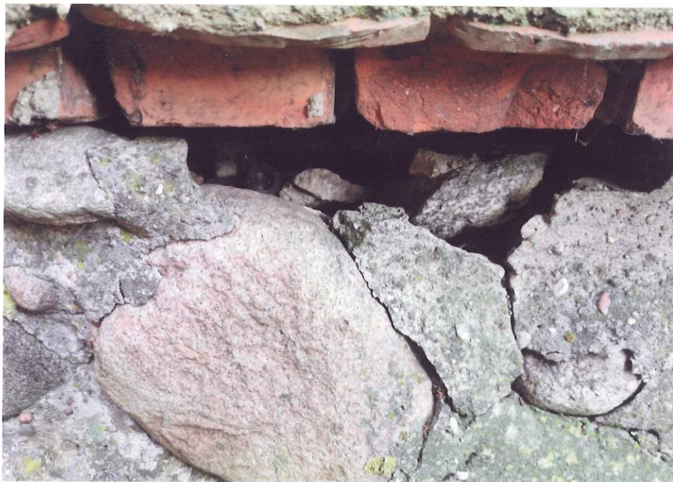
Fot 38 Ubytki zaprawy spajających
