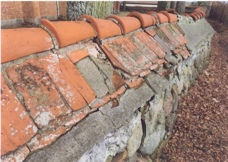
Fot 20. Stan zachowania nakrywy muru - pozostałości oryginalnej dachówki i gąsiorów
