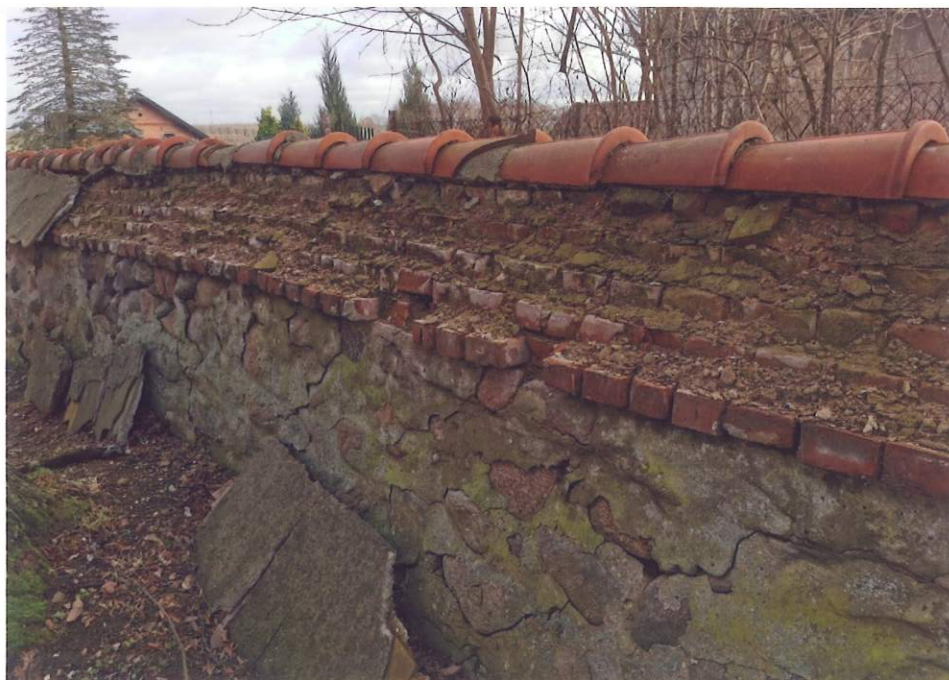
Fot 23. Uszkodzenia korony muru
