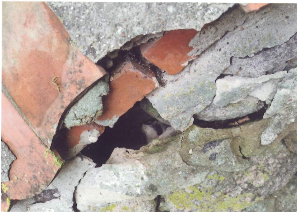
Fot 39. Ubytki zapraw spajających
