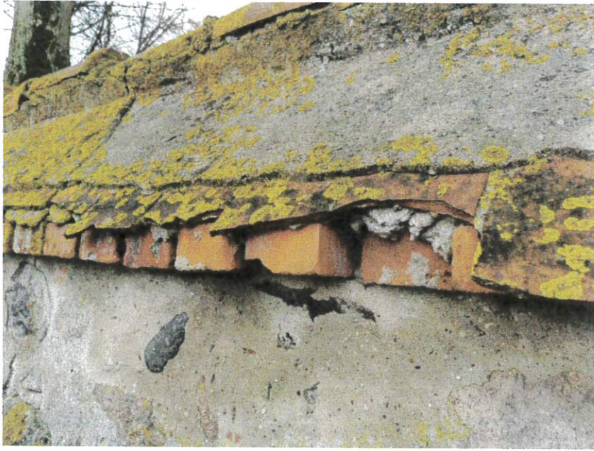
Fot. 27. Korozja biologiczna
