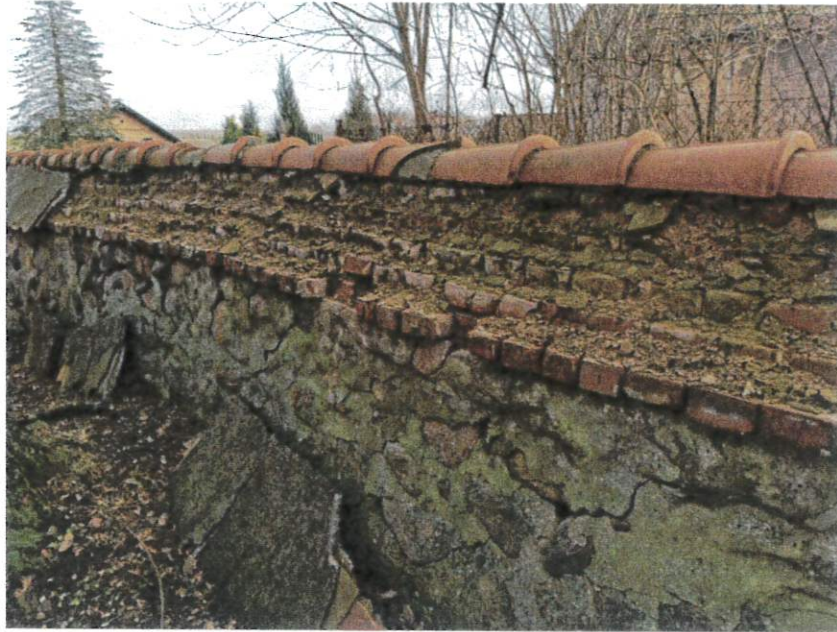
Fot. 23. Uszkodzenia korony muru
