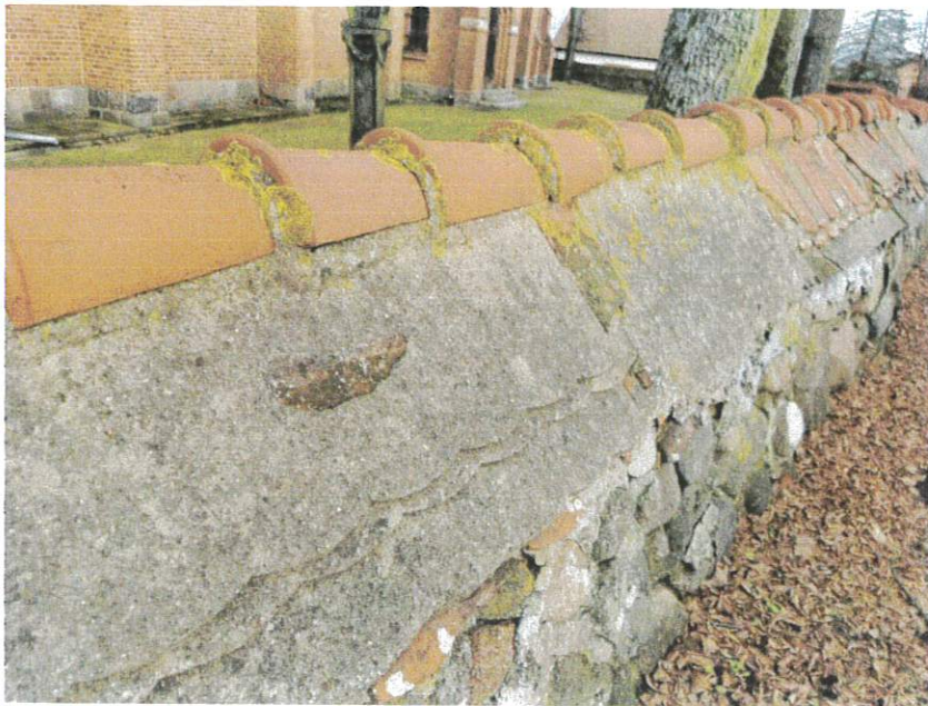
Fot. 15. Wtórna szlichta cementowa pokrywająca ceramiczną nakrywę
