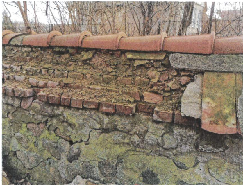
Fot. 22. Uszkodzenia korony muru
