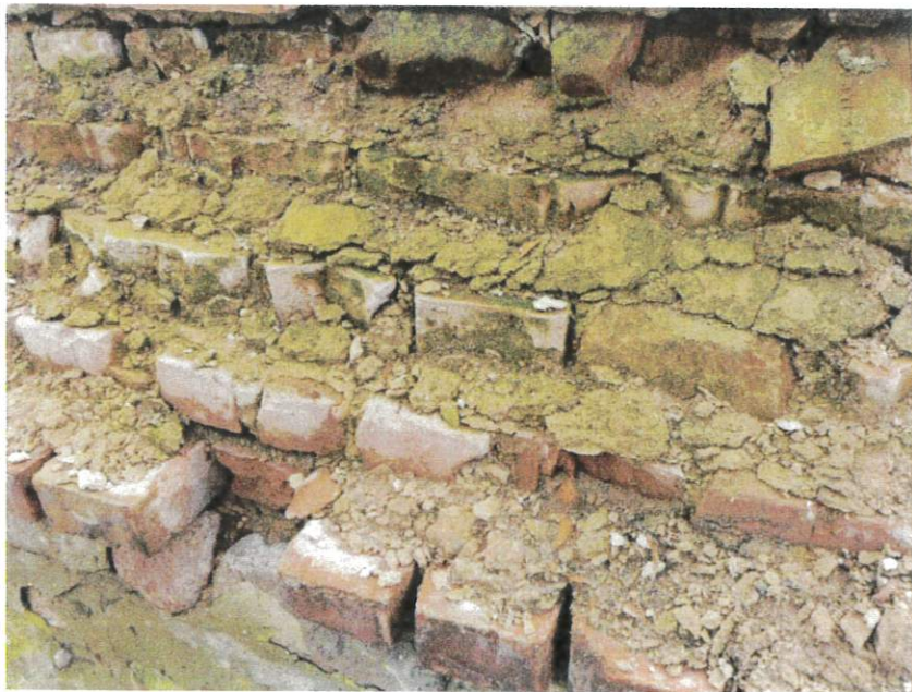
Fot. 24. Stan zachowania materiału ceramicznego korony muru
