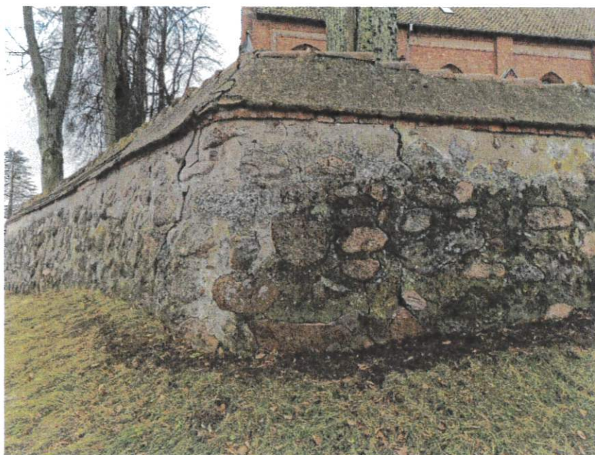
Fot. 45. Odspojenie naroża muru od strony północno-wschodniej
