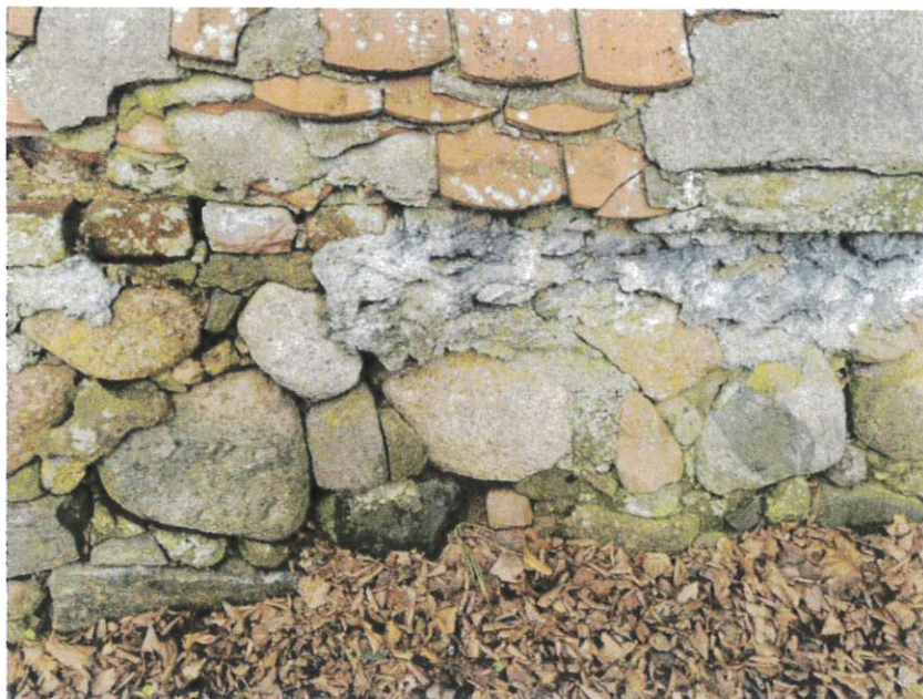
Fot. 31. Ubytki zaprawy spajającej materiał kamienny, wtórne cementowe reparacje
