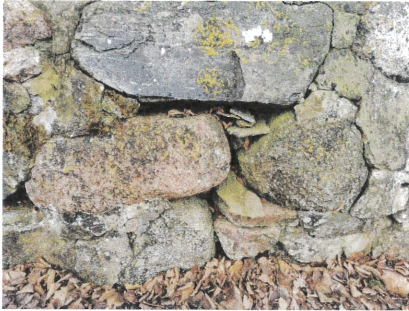
Fot. 33. Ubytki zaprawy spajającej materiał kamienny
