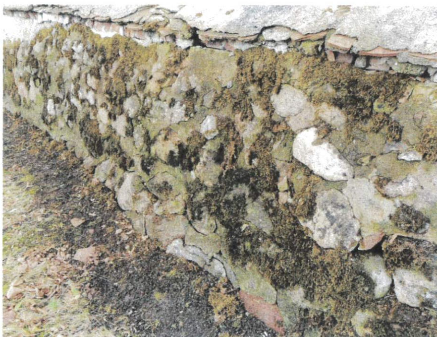
Fot. 26. Korozja biologiczna pokrywająca powierzchnię muru
