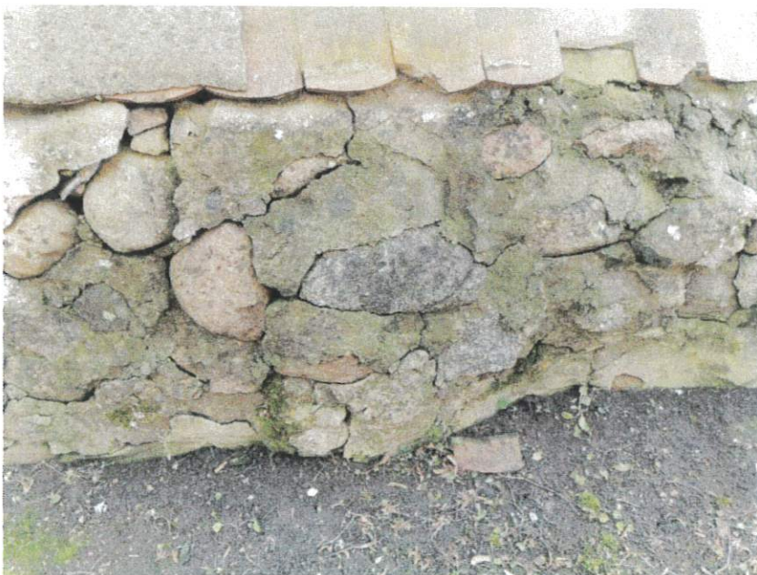
Fot. 44. Wtórne spękane wypełnienia cementowe wykonane zbyt silnymi zaprawami
