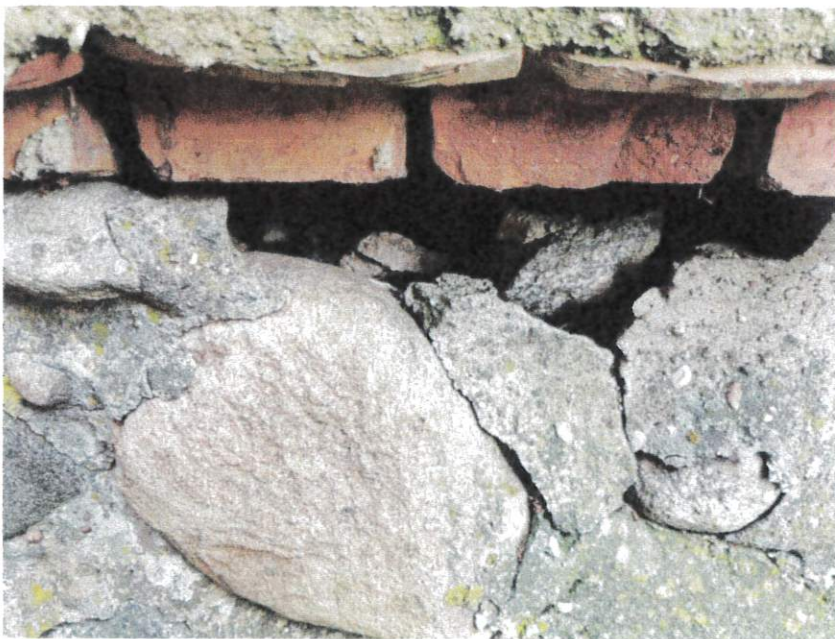
Fot. 38. Ubytki zaprawy spajających
