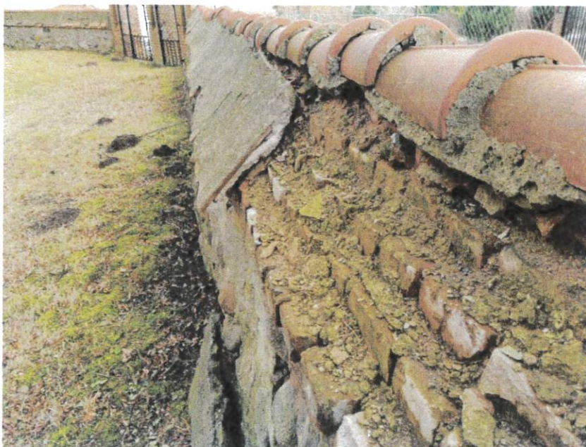
Fot. 25. Stan zachowania materiału ceramicznego korony muru
