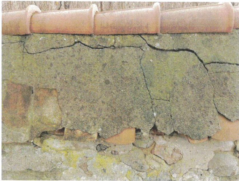
Fot. 19. Stan zachowania nakrywy muru
