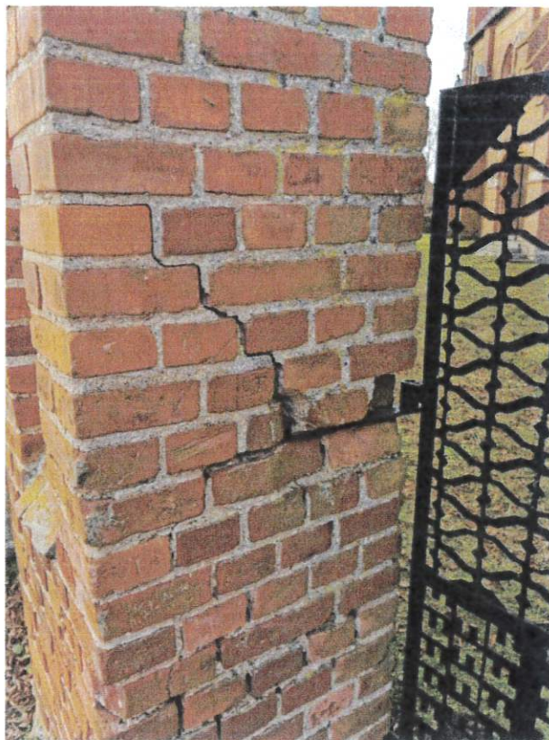
Fot. 53. Uszkodzenia elementów ceglanych słupów
