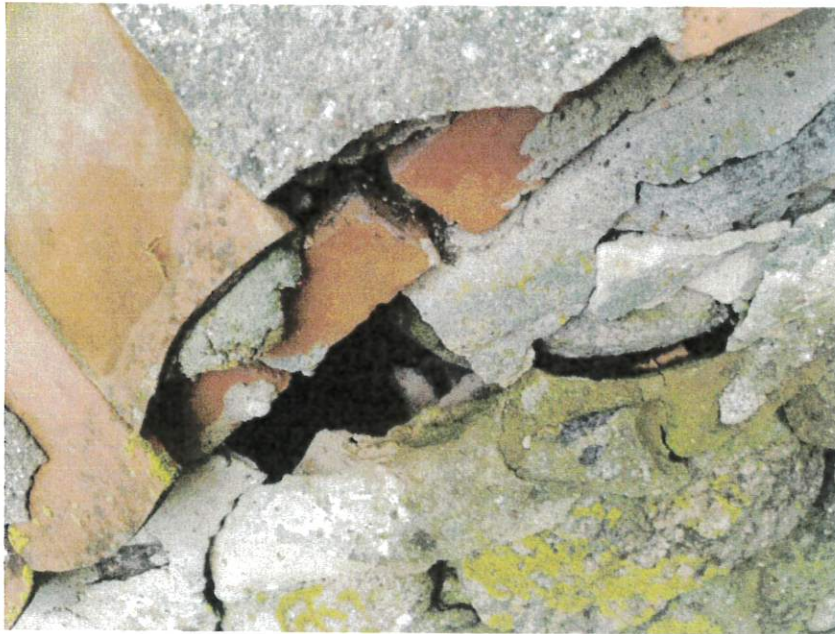
Fot. 39. Ubytki zapraw spajających
