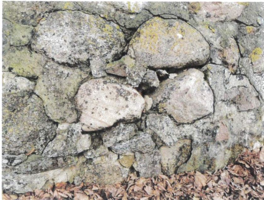
Fot. 34. Ubytki zaprawy spajającej materiał kamienny, wtórne cementowe reparacje
