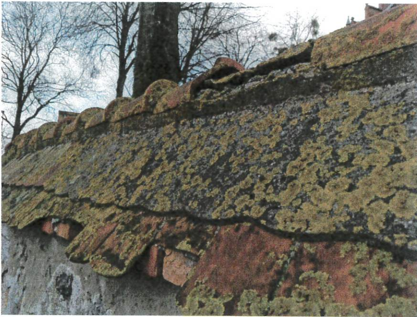
Fot. 28. Korozja biologiczna
