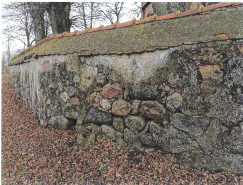
Fot. 29. Korozja biologiczna
