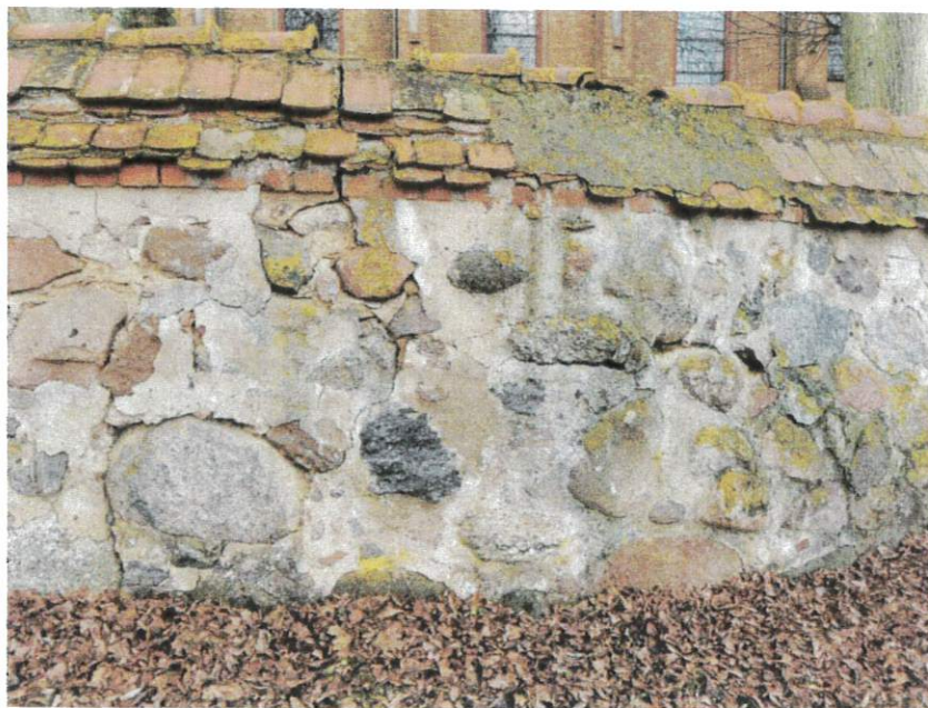
Fot. 48. Spękania muru
