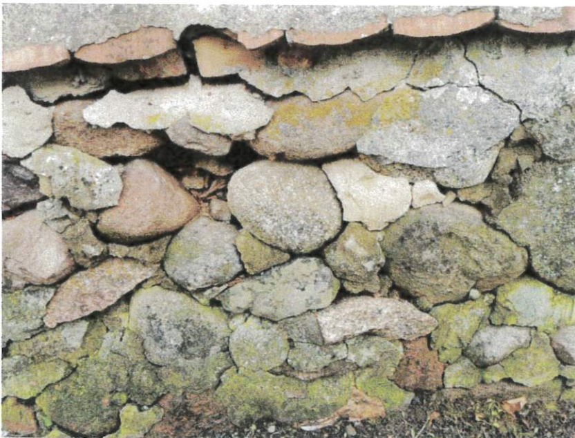
Fot. 36. Ubytki zaprawy spajającej materiał kamienny, wtórne cementowe reparacje
