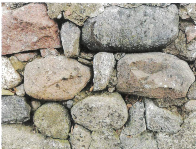
Fot. 32. Ubytki zaprawy spajającej materiał kamienny
