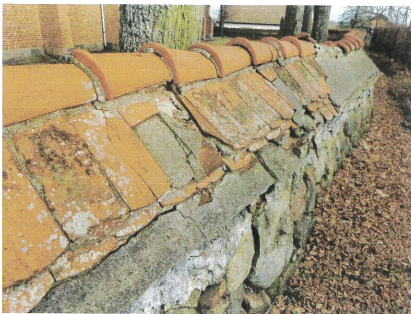
Fot. 20. Stan zachowania nakrywy muru - pozostałości oryginalnej dachówki i gąsiorów
