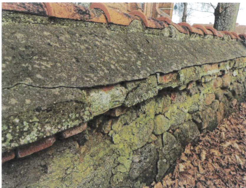
Fot. 18. Stan zachowania nakrywy muru
