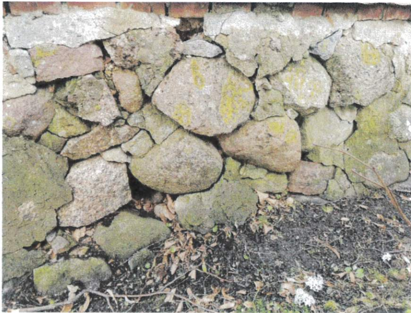
Fot. 37. Ubytki zaprawy spajającej materiał kamienny, wtórne cementowe reparacje
