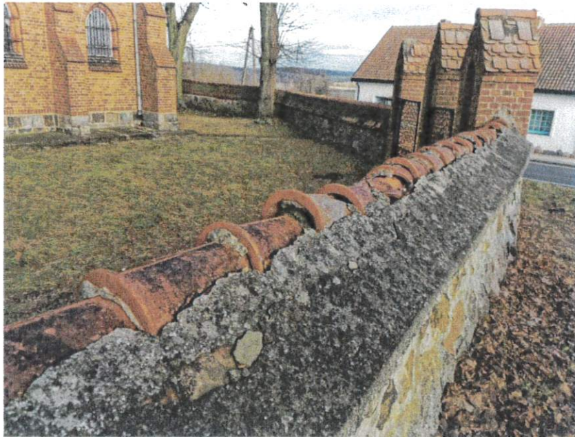
Fot. 17. Wtórna szlichta cementowa pokrywająca ceramiczną nakrywę
