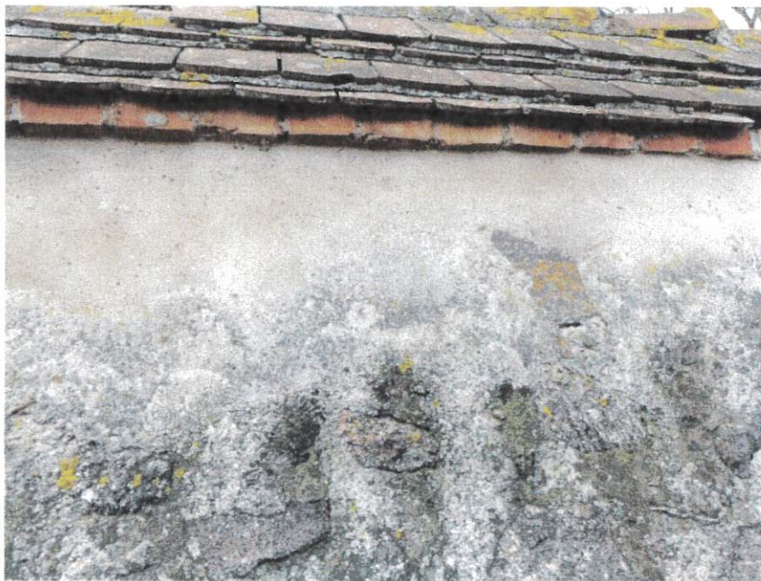
Fot. 42. Wtórne szlichty cementowe pokrywające materiał kamienny
