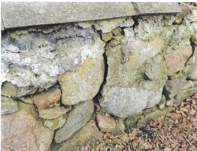
Fot. 30. Pęknięcia konstrukcji muru, ubytki zaprawy spajającej
