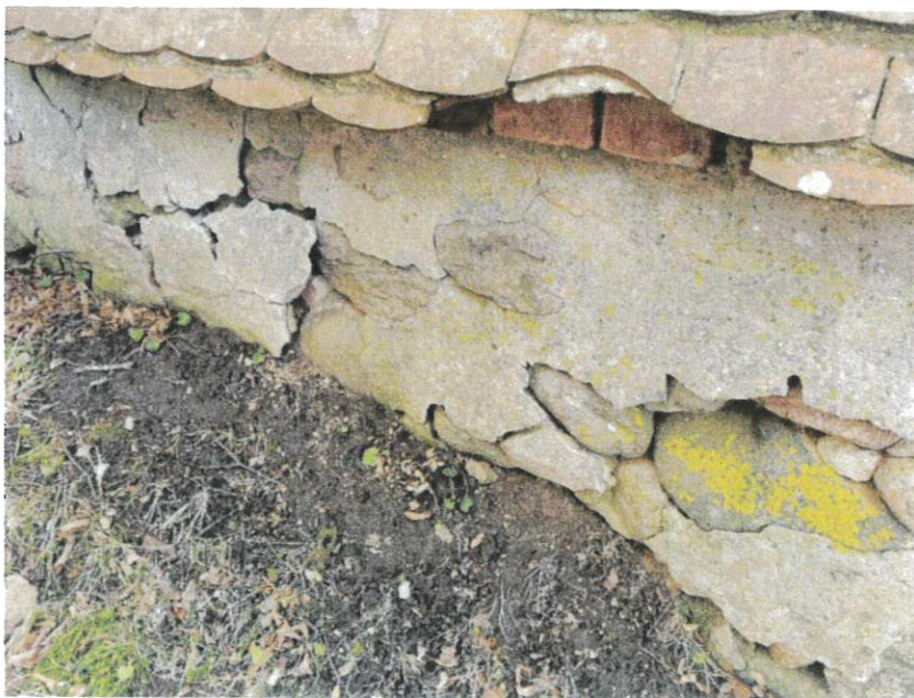
Fot. 43. Wtórne odparzone szlichty cementowe
