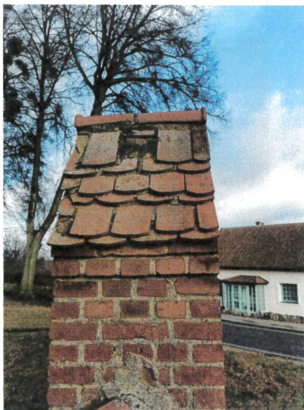
Fot. 52. Stan zachowania pokrycia słupów z dachówki ceramicznej
